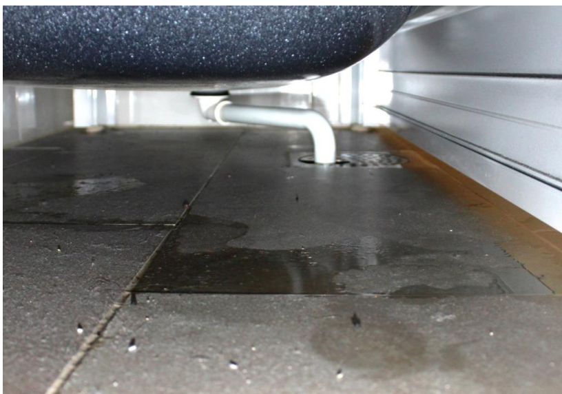
Figur 2: Under løststående badekar kan samles mye vann om ikke der er fall. God avrenning bort fra vegg og på skjulte flater er nødvendig så vannet ikke samles i svanker.
