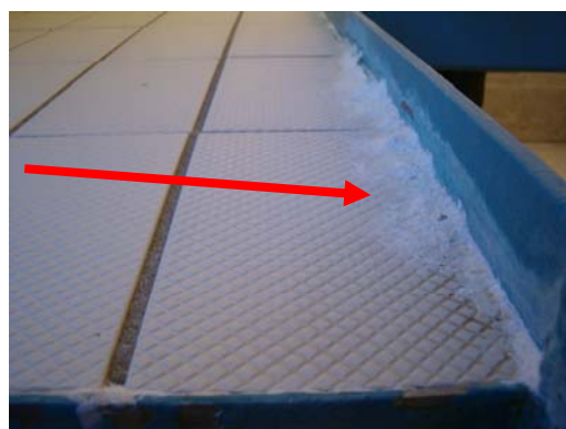
Bilde4: Utfellinger av kalsium opptrer i vann med positiv LSI kombinert med nedfuktet påstøp.
