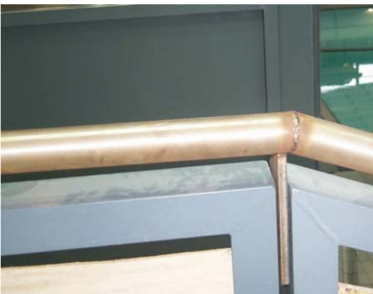
Figur 3 Slørrust/overflate rust på slipt overflate (håndreil)
