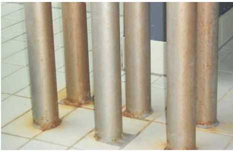
Figur 5 Overflaterust på sveiser med en matt overflate
