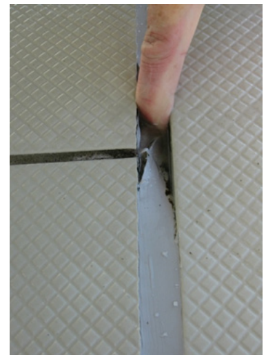
Figur 7: Fugemasser på MS- eller silikonbasis i bredde over 20 – 25 mm har levetid på 3-4 år.
