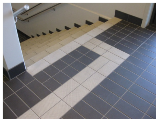
Figur 4: Trappetrinnets ytterste 40 -50 mm bør ha en kontrastfarge forskjellig fra grunnfargen. I denne trappa blir trinnene lite synlige for en svaksynt grunnet de brede frontflisene.
