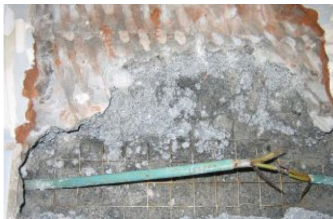
Figur 1: At kabler slutter å fungere har ulike årsaker. Fuktig støpemasse og høy temperatur er en uheldig kombinasjon.
