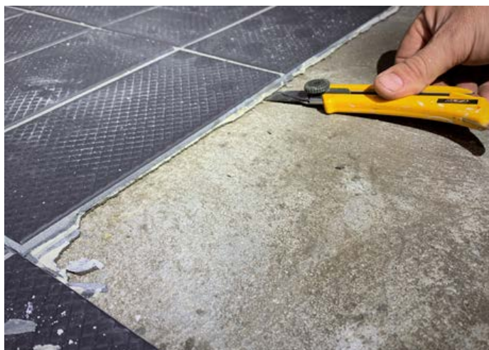
Figur 3: Bomlyd registrertes over ca 70% av golvet. Flisene har sluppet fra underlaget og kunne lett plukkes bort.
