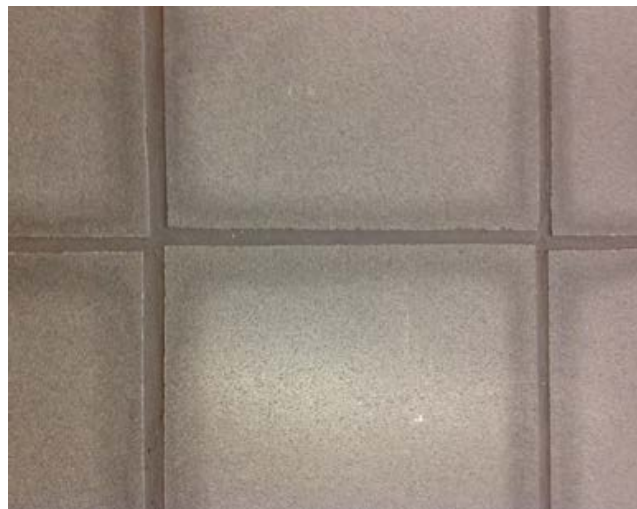
Figur 5: Grå basalt som har fått en dypere gråfarge grunnet fugemassen.
