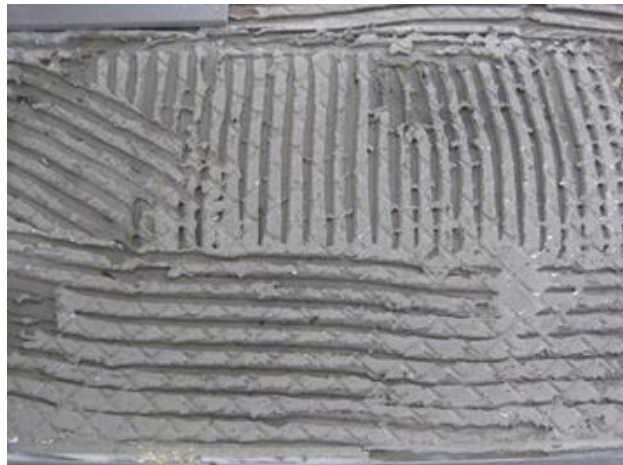
Figur 5: "Slakteprøven" viste mangelfull limdekningen ved bruk av standard lim i kombinasjon med storformater. F.eks. brukt utendørs ville dette resultert i frostsprengning. Generelt anbefales enten flytlim eller dobbelliming utendørs.
